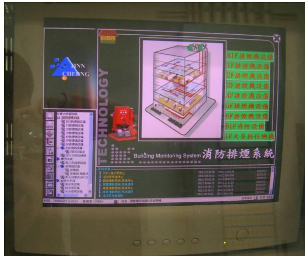
圖 12. 大樓消防監控系統
