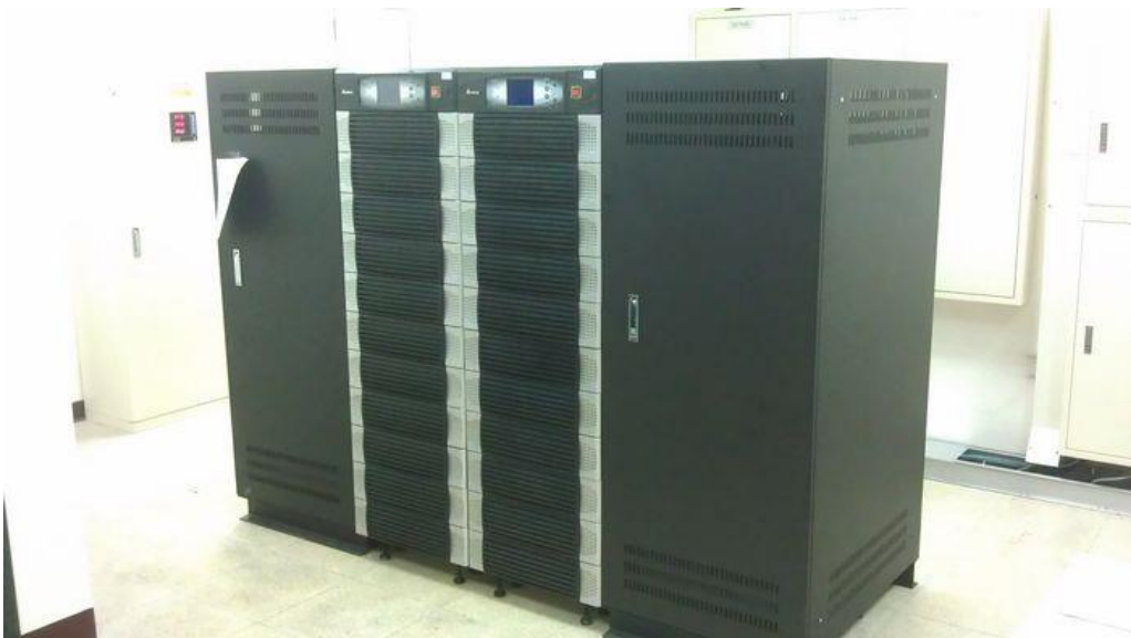
圖 4.不斷電系統主機
