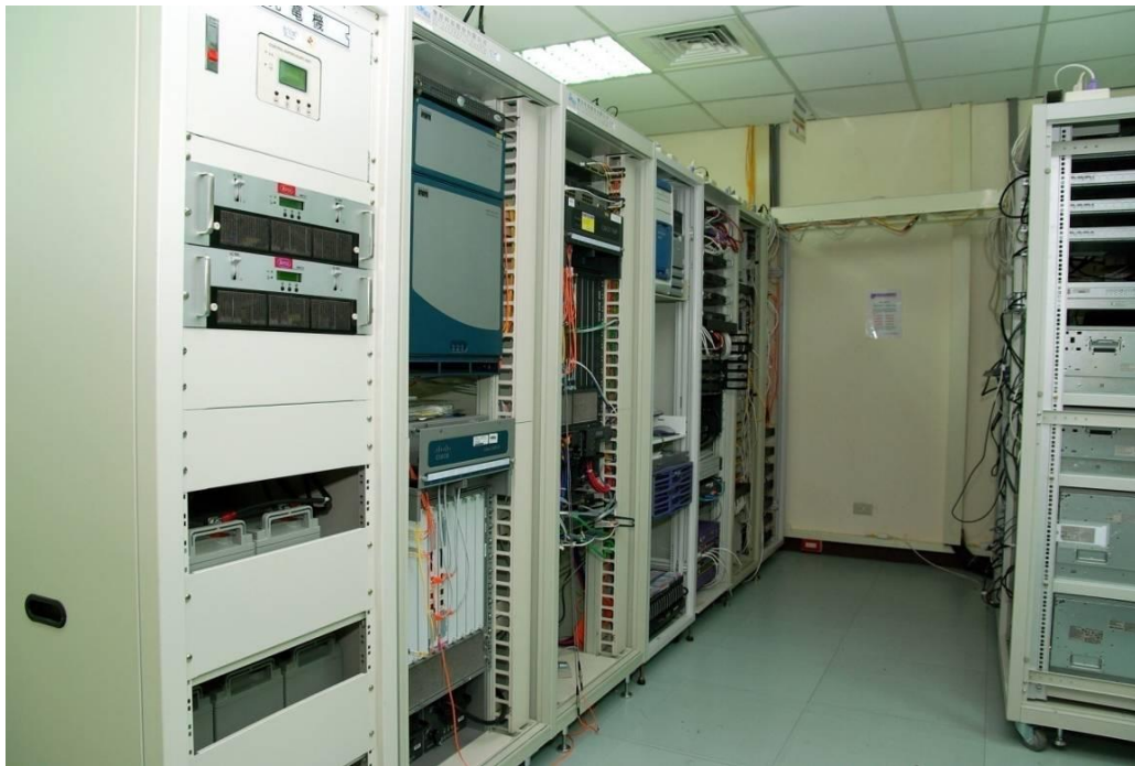
圖 3.機房內部維運設備
