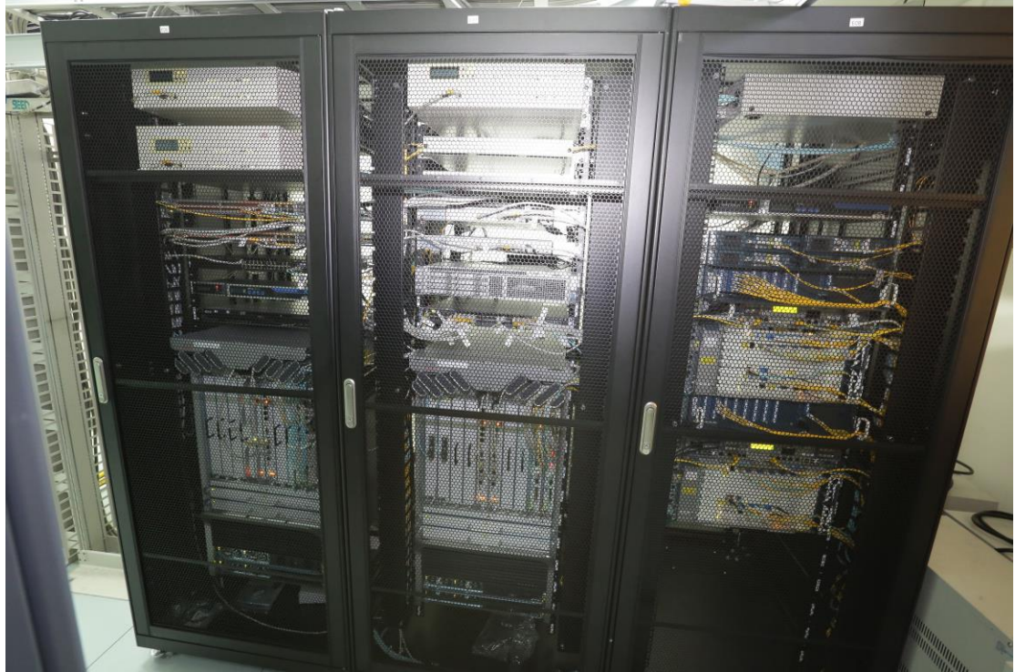
圖 2.機房(100G 設備)
