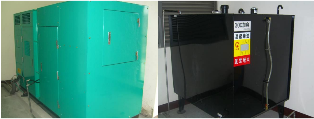
圖 5.網路機房發電機及油箱
