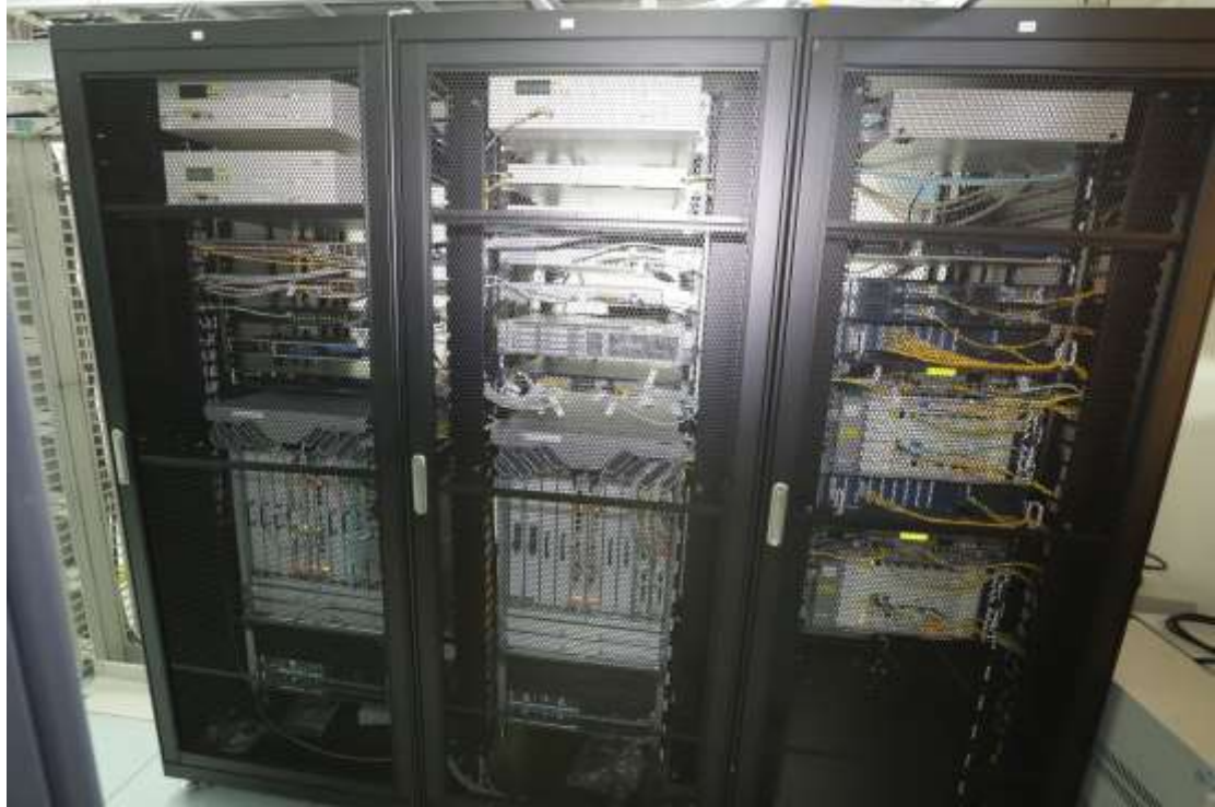
圖 2.機房(100G 設備)
