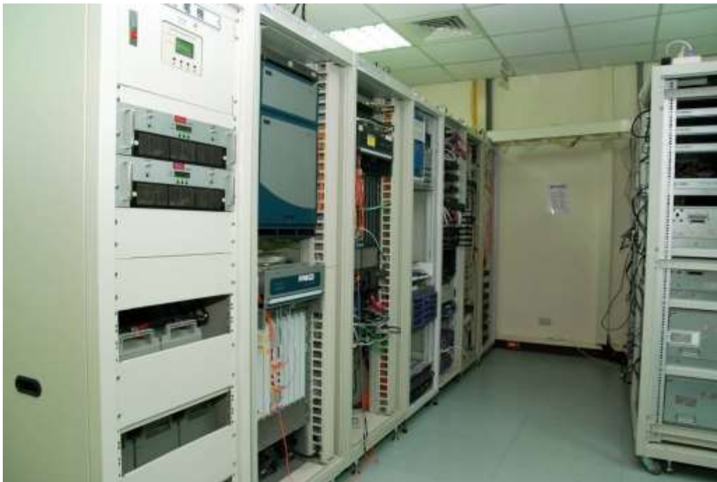
圖 3.機房內部維運設備
