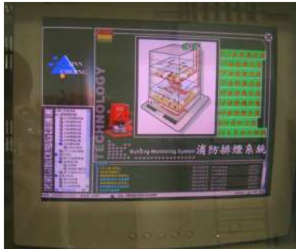
圖 12. 大樓消防監控系統
