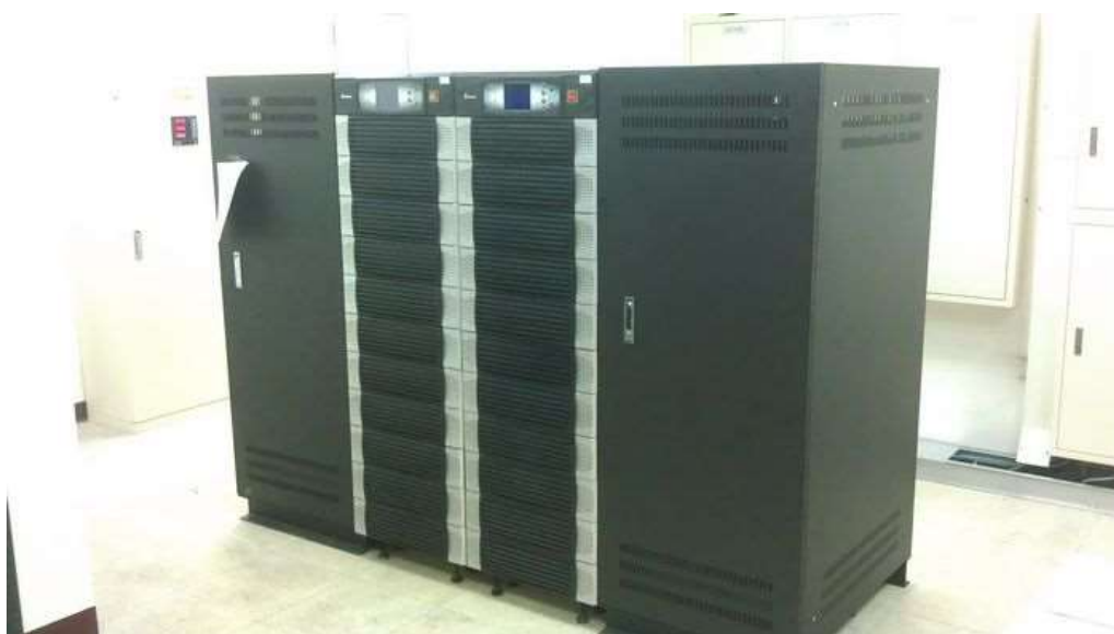
圖 4.不斷電系統主機
