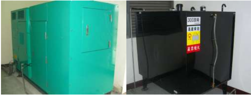
圖 5.網路機房發電機及油箱
