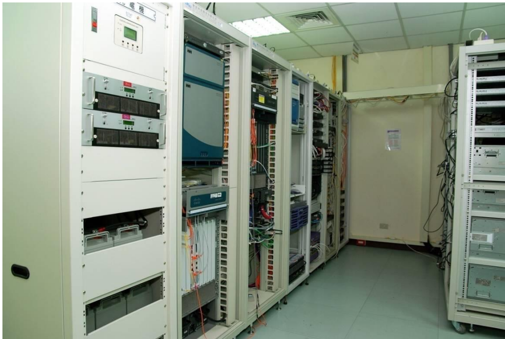
圖 3.機房內部維運設備
