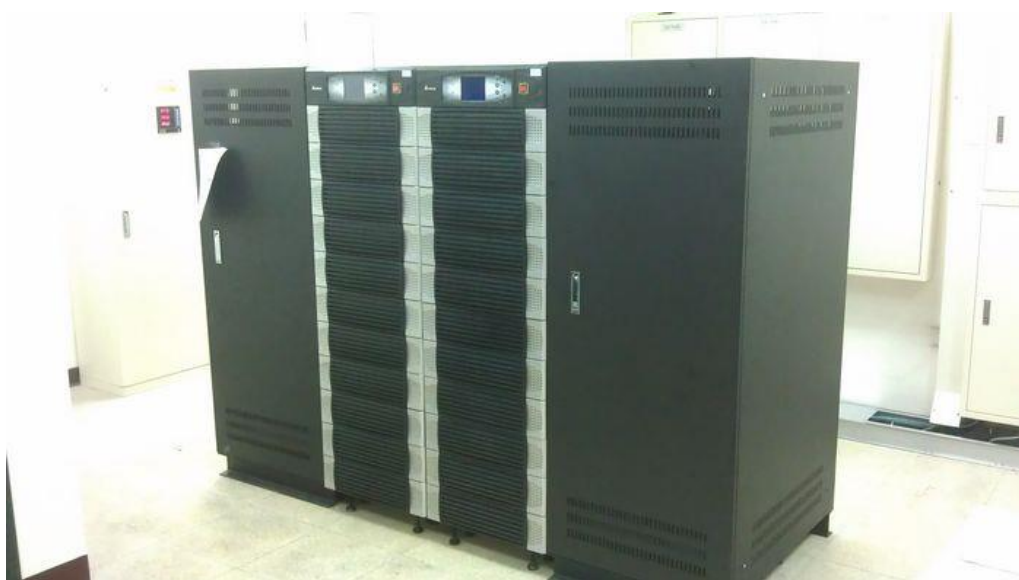
圖 4.不斷電系統主機
