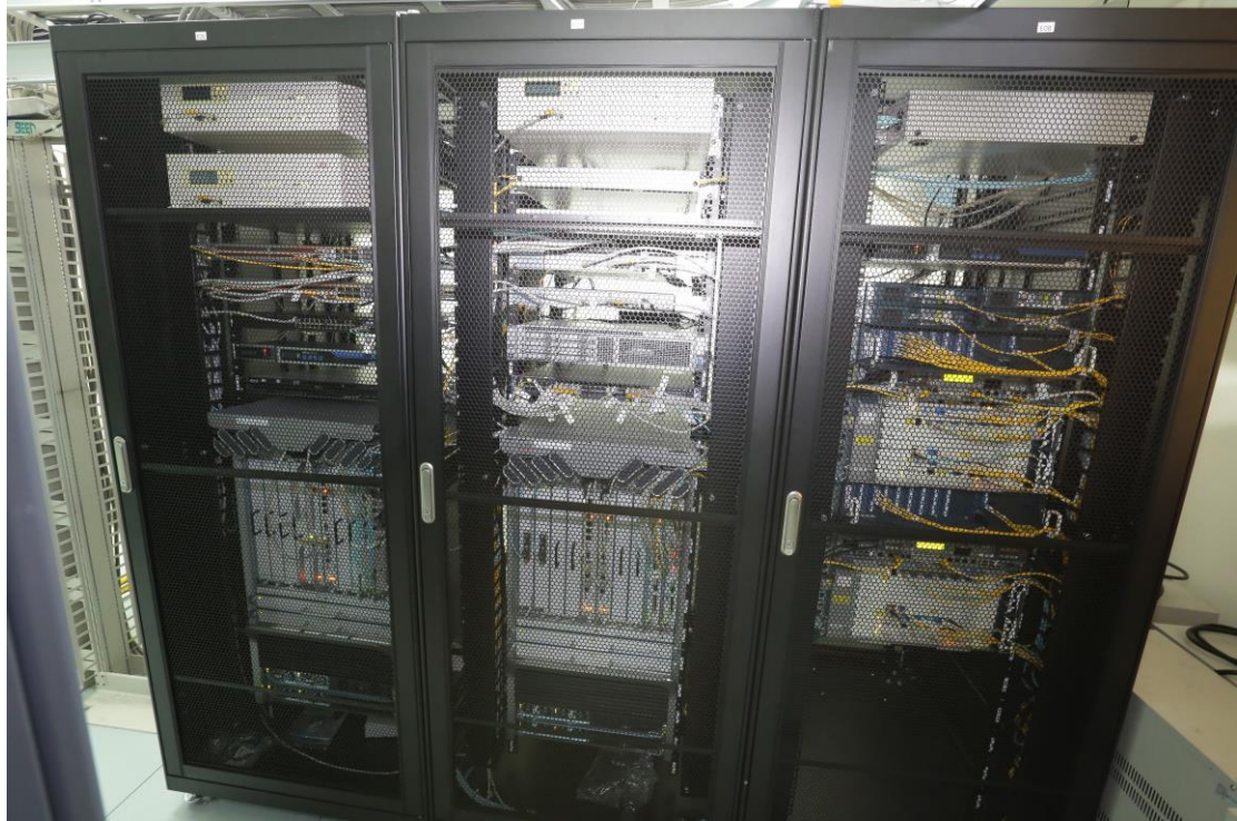
圖 2.機房(100G 設備)
