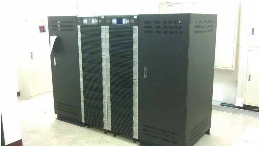
圖 4.不斷電系統主機
