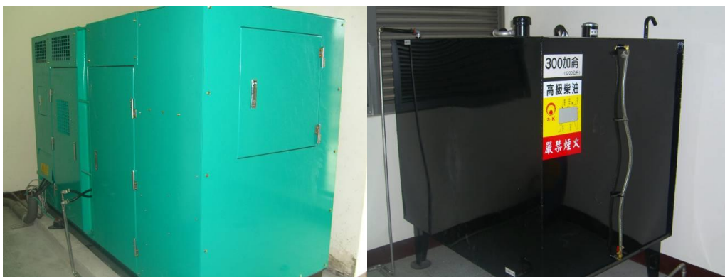
圖 5.網路機房發電機及油箱
