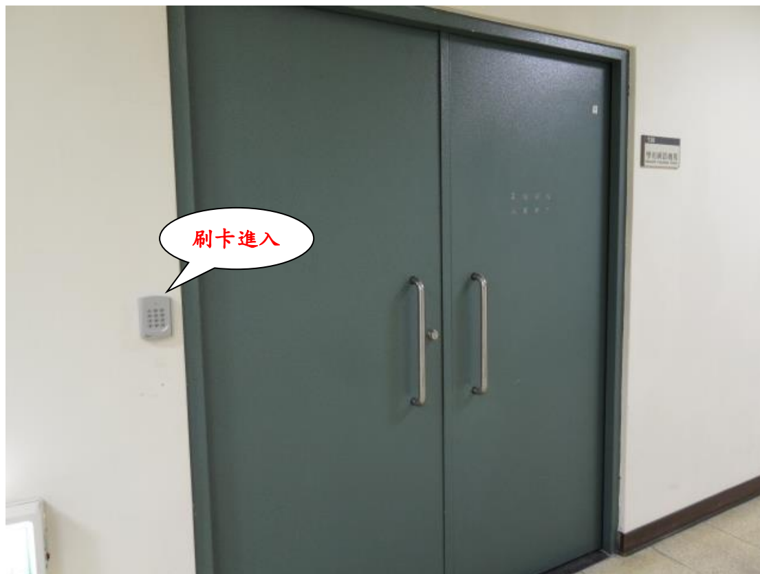
圖 17. 第二層網路機房外門
