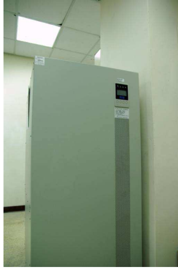
圖 5(a).不斷電系統主機正面
