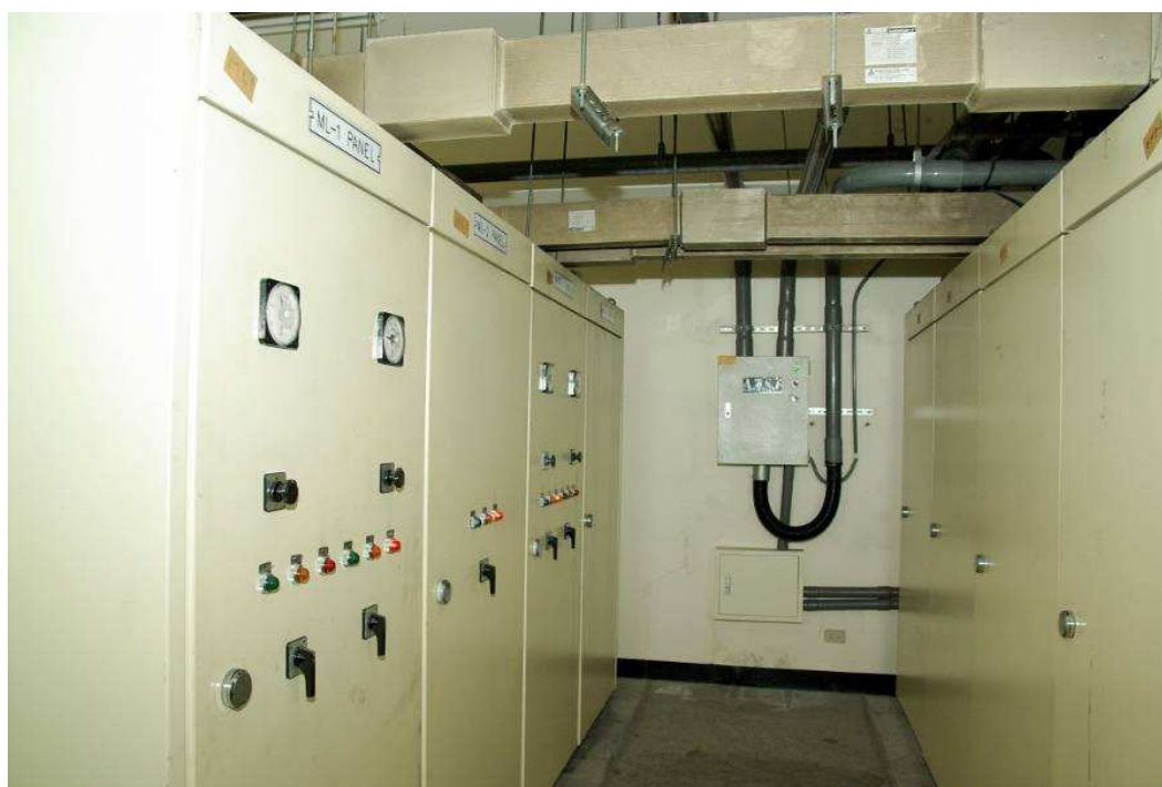
圖 4.大樓電力系統與發電機測試盤
