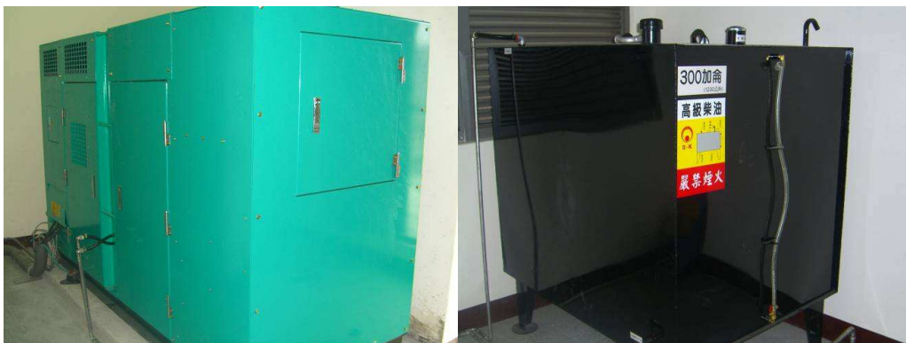
圖 6.網路機房發電機及油箱
