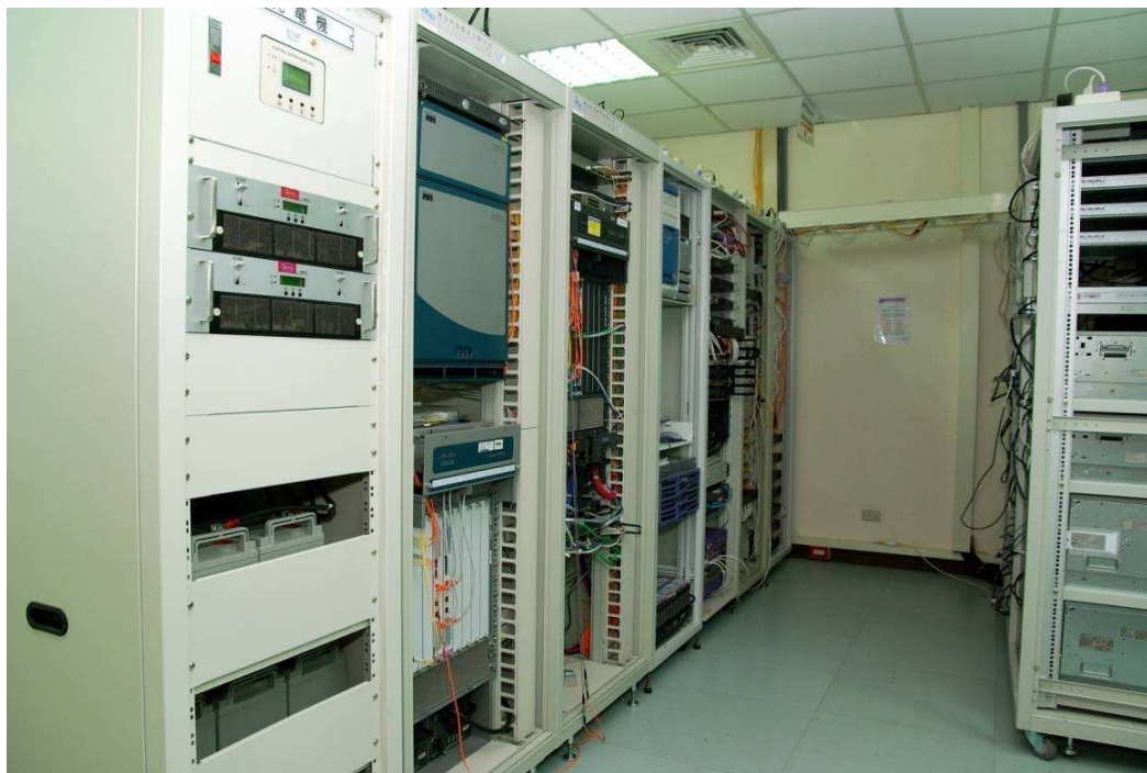
圖 3.機房內部維運設備
