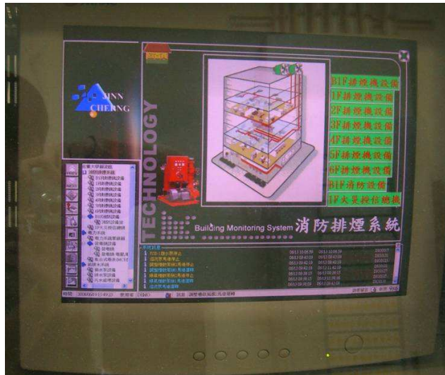
圖 12. 大樓消防監控系統
