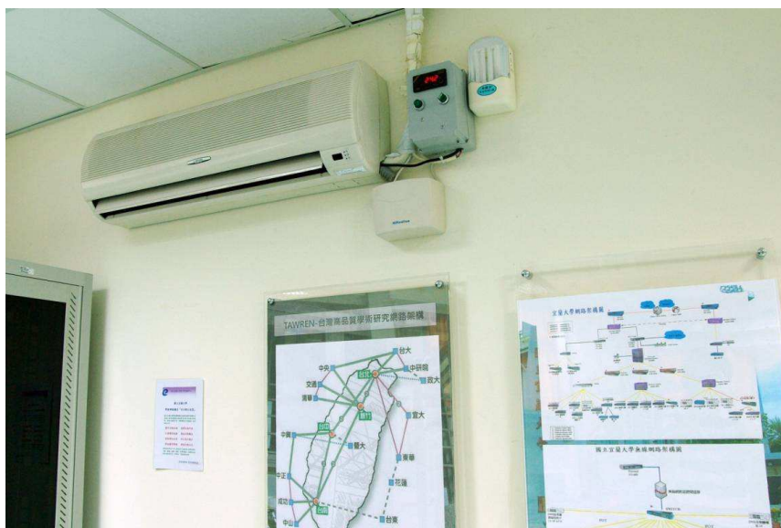
圖 7. 機房獨立空調設備
