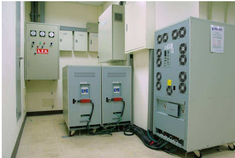
圖 5(b).不斷電系統主機，電池盒與配電盤
